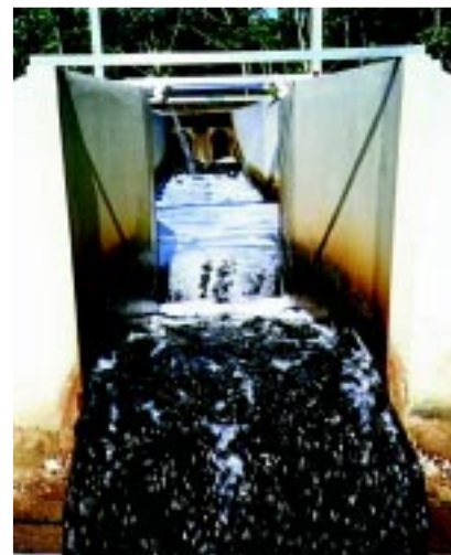
Figura 4. Aguas residuales sanitarias brutas, antes del tratamiento CEPT-TPA
